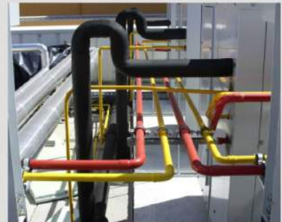
(sistemas de refrigeração remotos)
